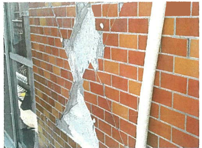
バルコニー側非耐力壁に発生したX字型亀裂によるタイルの剥落
