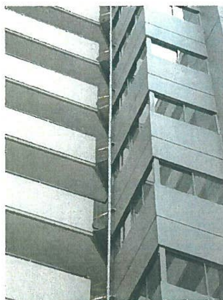
エクスパンションジョイント部の手摺が落下している
