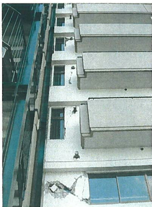
縦系列の同じ箇所が損傷している
