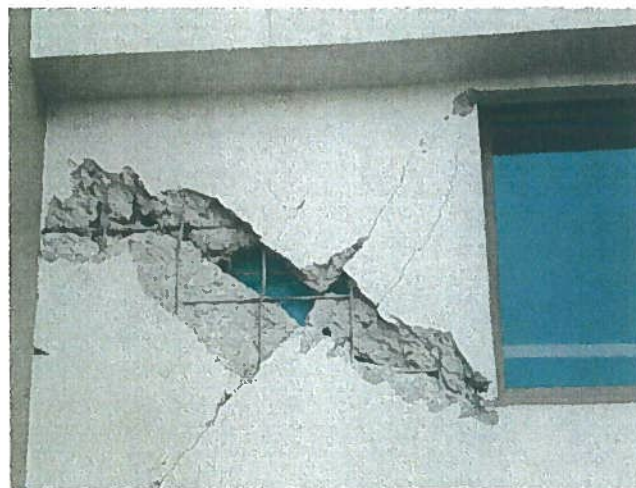
窓横に発生している大きな亀裂
