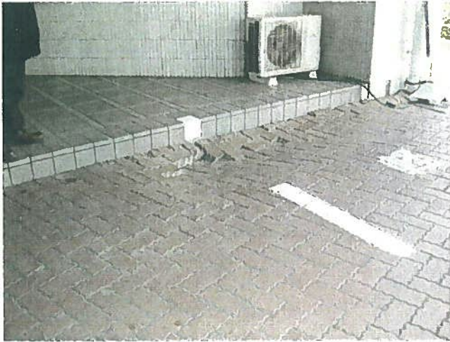
エントランス前のインターロッキングが陥没している
