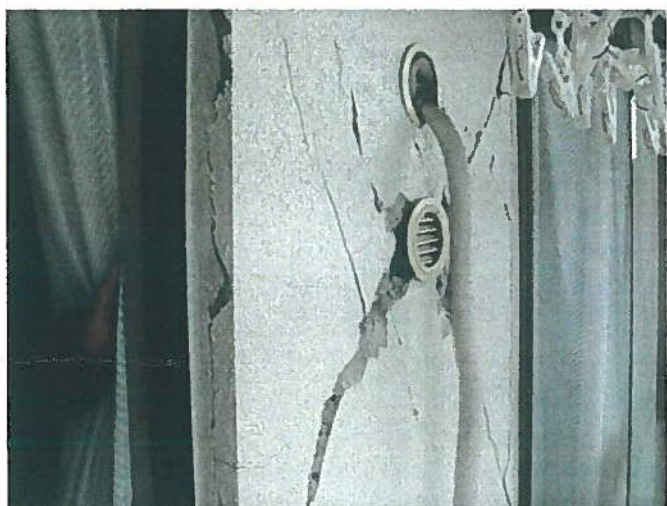
バルコニー側非耐力壁に発生しているX字型亀裂
