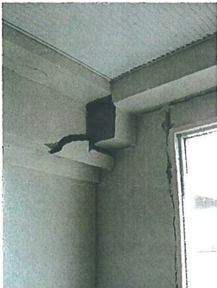
エキスパンションジョイント部に発生した亀裂
