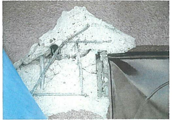
共用廊下の壁に発生している露筋箇所
