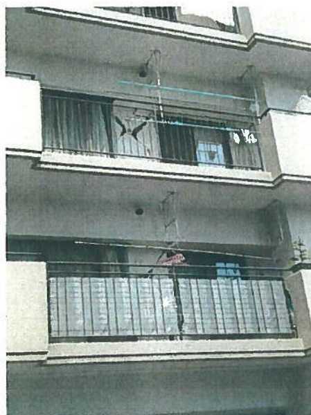
バルコニーの非耐力壁に発生しているX字型亀裂
