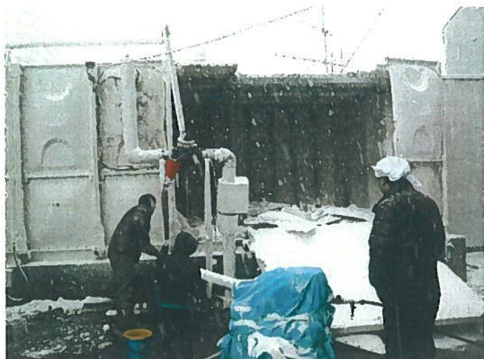
地上に設置されたユニット型FRP製受水槽の壁が破れ、大きく破損している。
