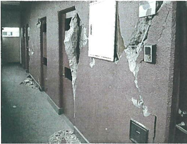
前頁の写真と同じマンションの共用廊下の壁に入った亀裂鉄筋が露出している。この程度の被害が最もひどい部類
