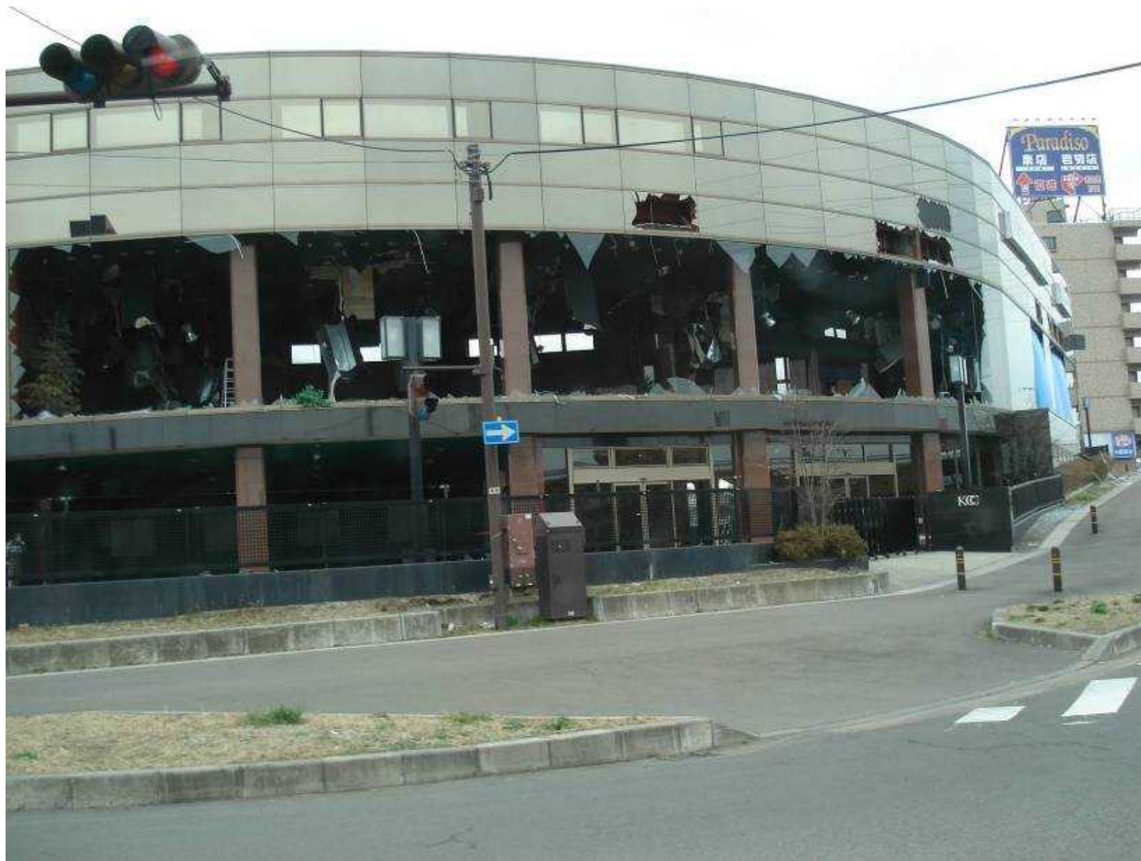
外装材(パネル・ガラス)の破損
