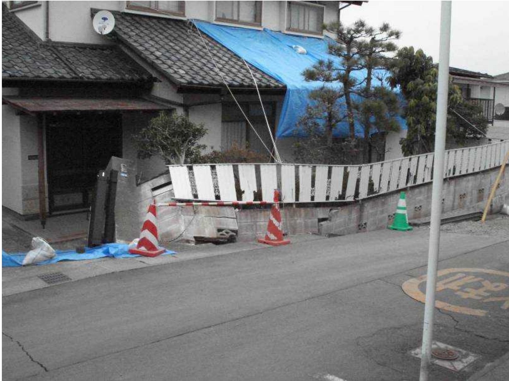
ブロック塀の崩壊
