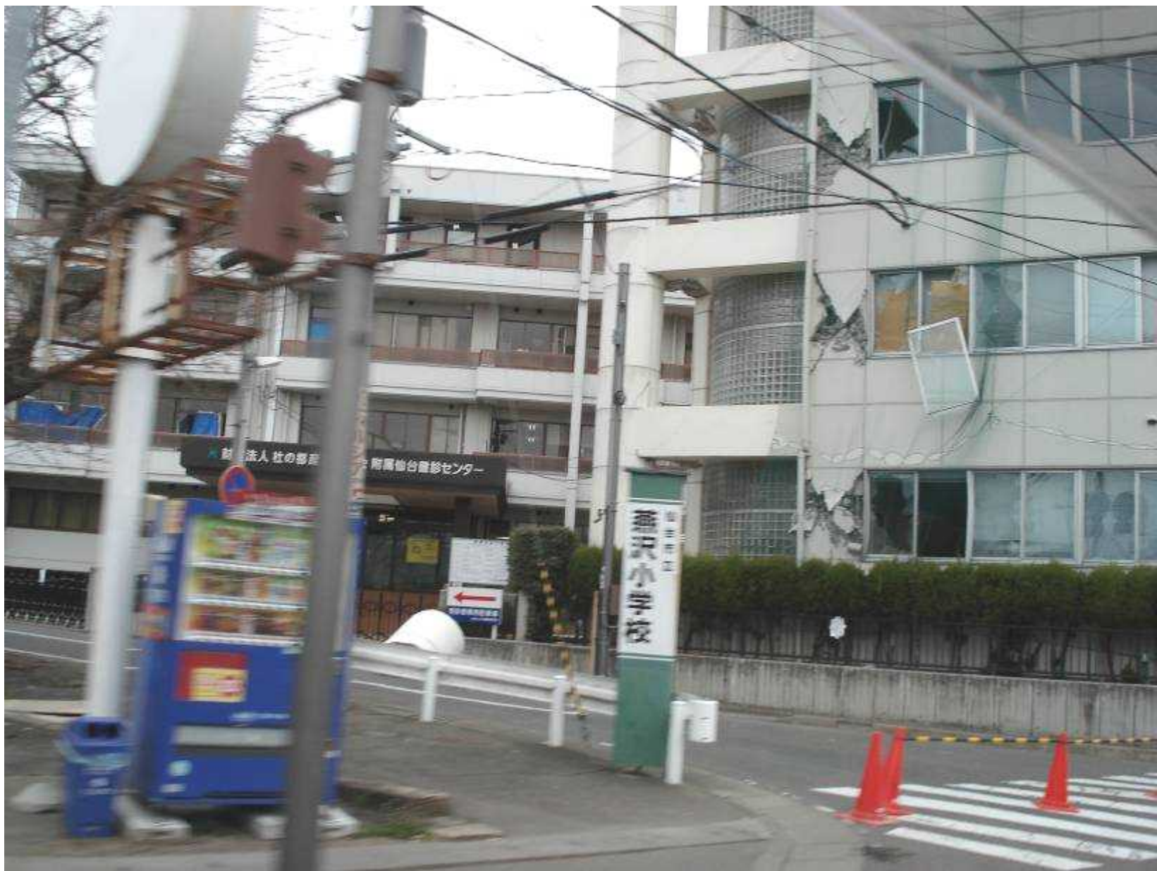
外壁材の破損
