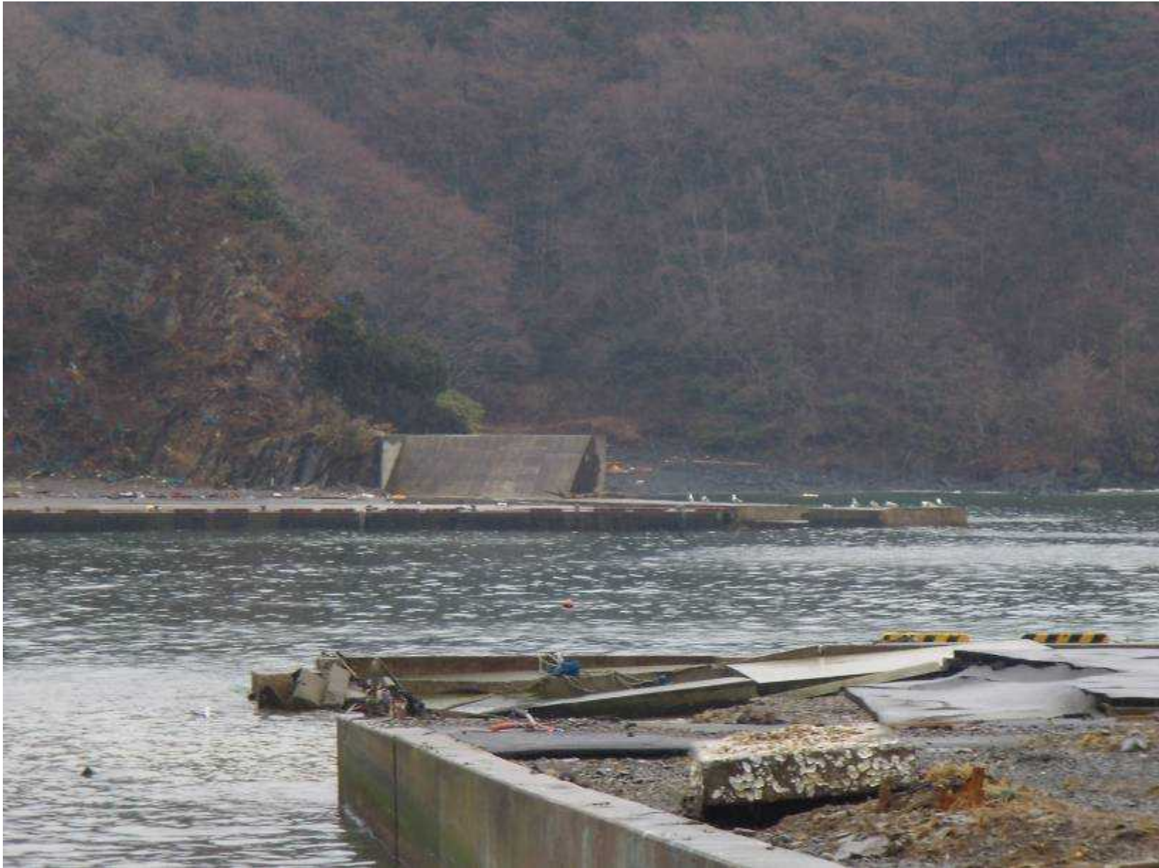
相川港(津波にさらわれた防潮堤)
