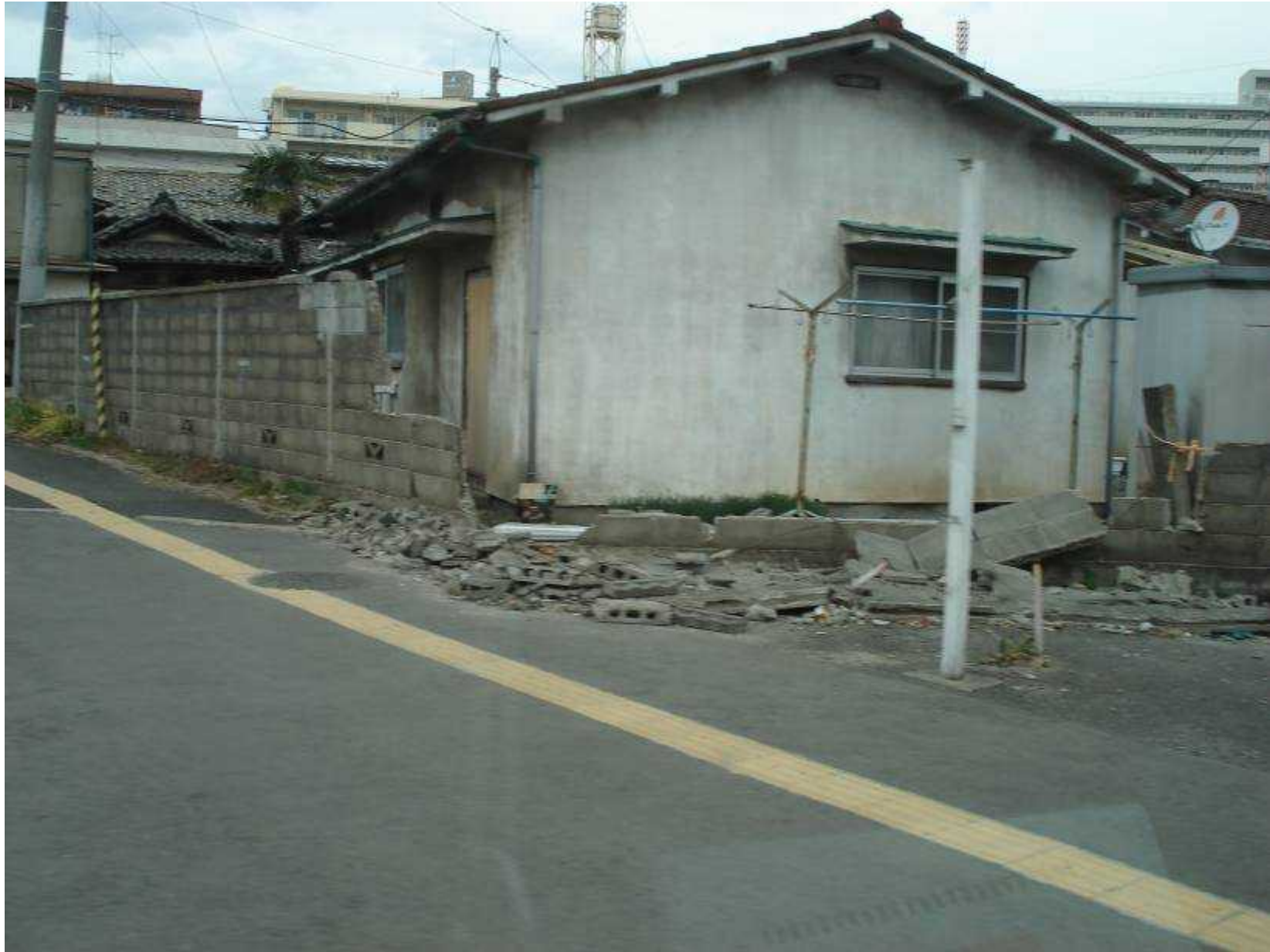
ブロック塀の崩壊
