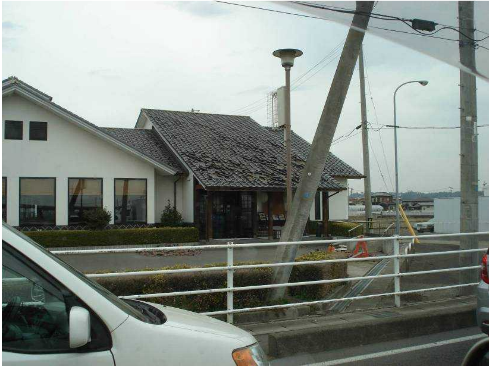
屋根瓦の落下
