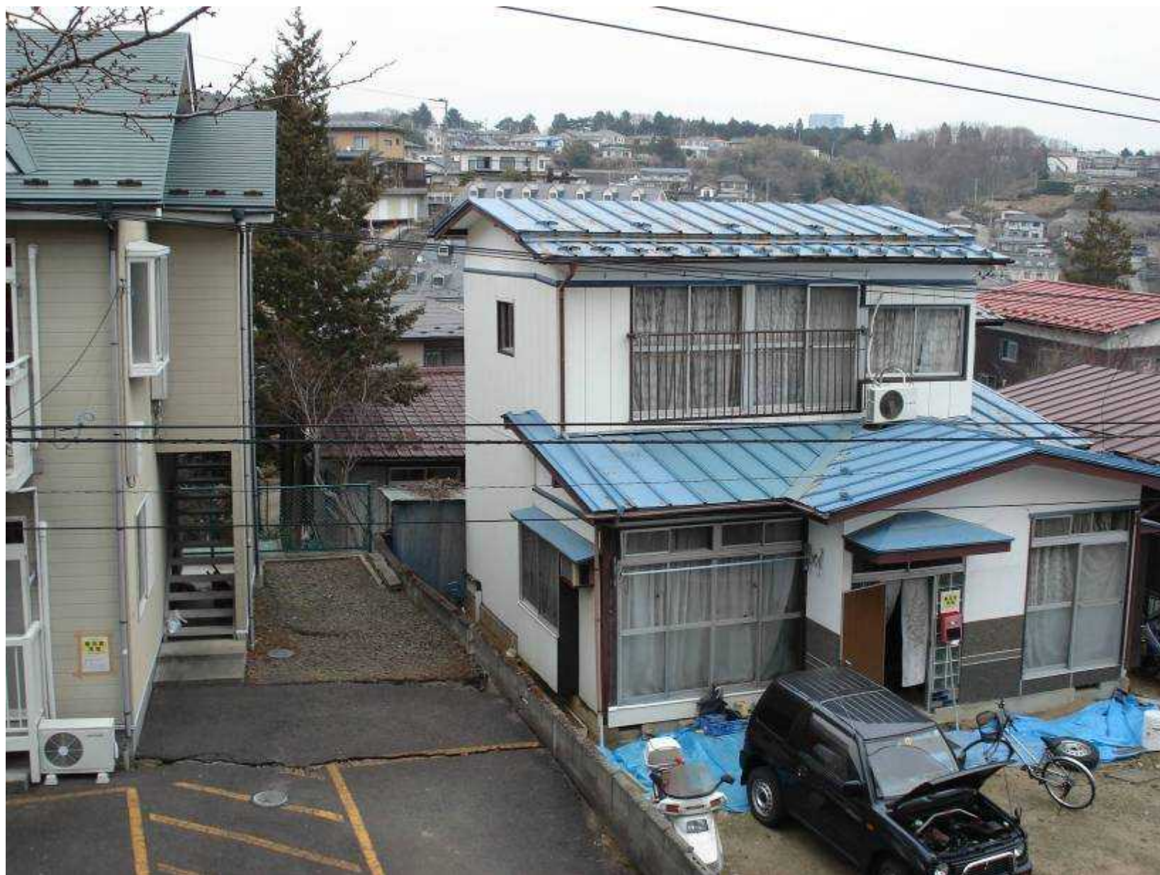
仙台市太白区緑ヶ丘四丁目(地滑り被害)
