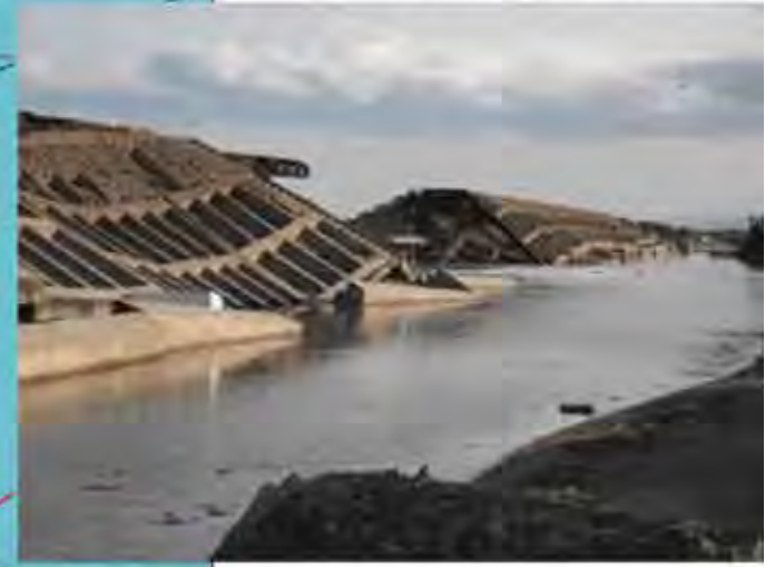
岩沼市二の倉海岸の被害状況
